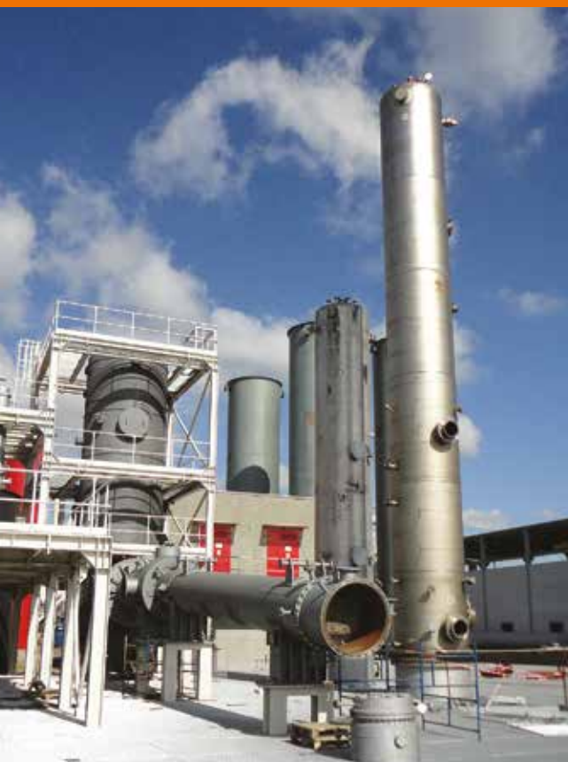
Instalacja oczyszczania gazu koksowniczego
